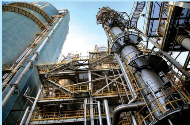
Tháp tạo hạt Nhà máy Đạm Phú Mỹ. Ảnh: DPM
