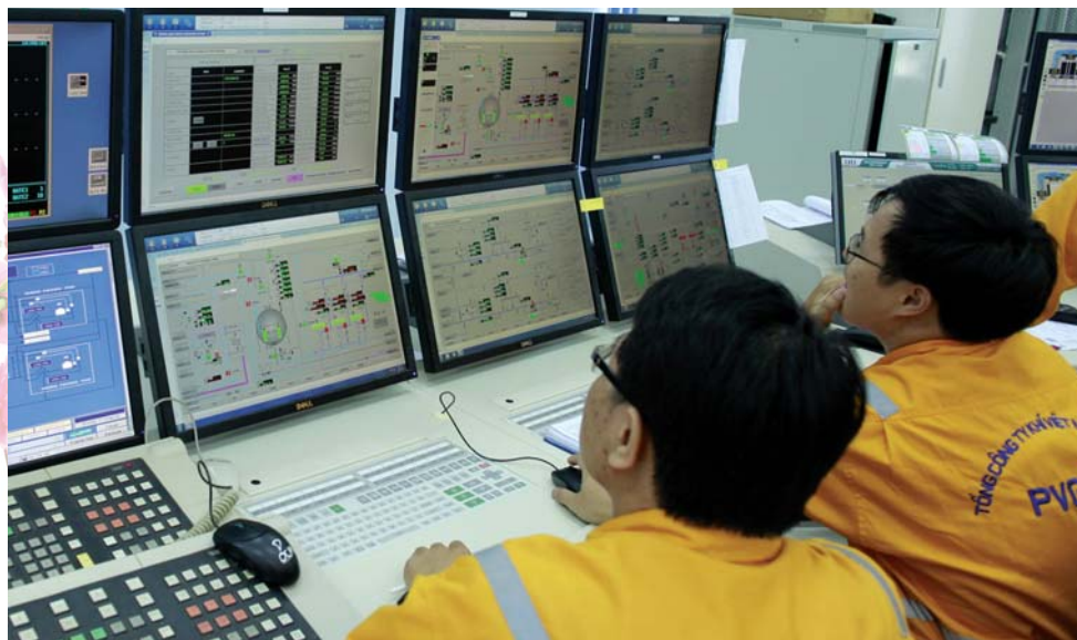
Cán bộ, kỹ sư PV GAS đảm bảo vận hành an toàn, hiệu quả, ổn định các công trình khí với hệ số tin cậy cao. Ảnh: PV GAS
